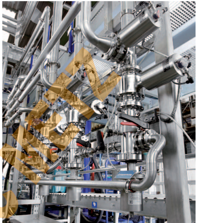
Technique de raclage KIESELMANN dans une production
